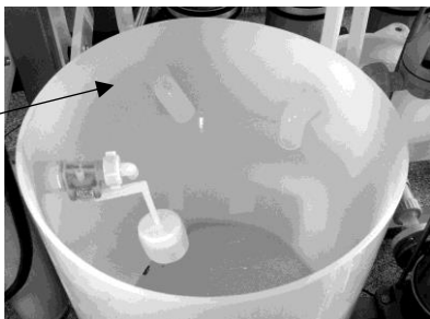
Tanque de entrada
